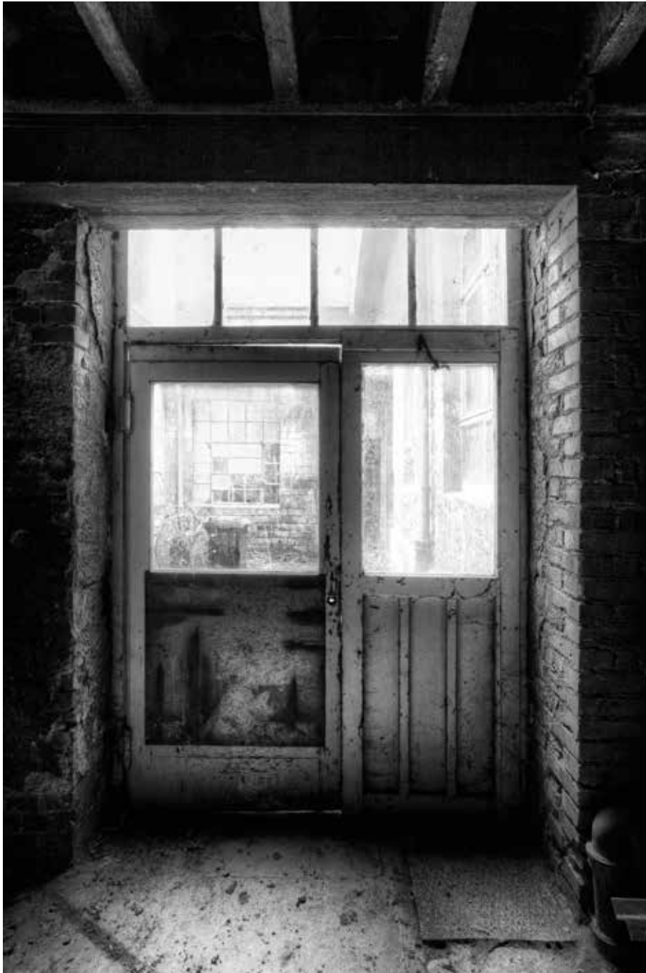
Abb. 47: Was vom Werke übrig blieb | Studie 26. Durchtritte und Durchblicke ergaben sich an vielen Stellen des Werks, und insofern greift diese Aufnahme das Momentum der Studie 01 auf. Die von solchem Standpunkt aus schemenhaft auftauchenden Hinterräume und Raumfluchten laden zur Erkundung ein, geben ihre Geheimnisse aber zunächst noch nicht preis.
